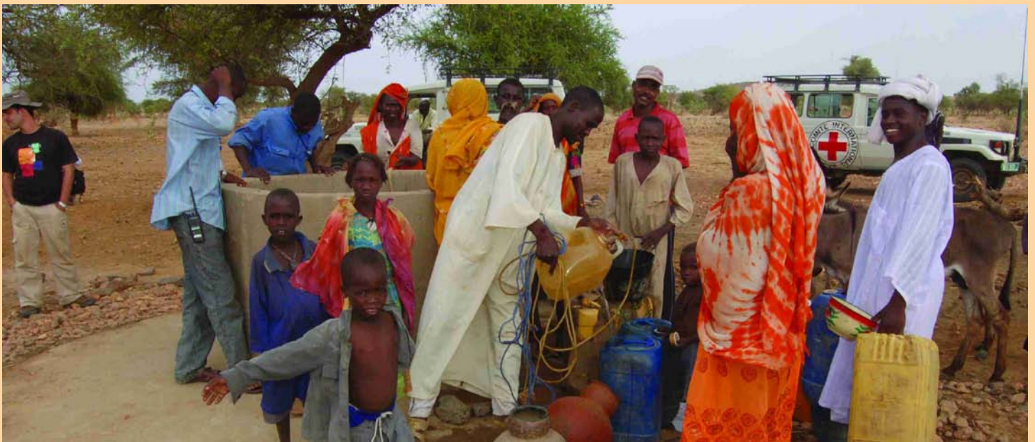
Un puits creusé dans le village d'Harouftama (à 55 Km de Goz Beïda)
