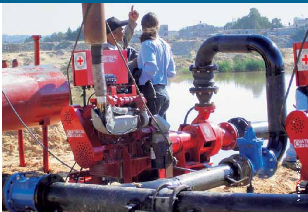
Système de pompage d'urgence à Beit Lahia mis en place afin d'éviter une rupture de la digue du bassin récoltant les eaux usées
